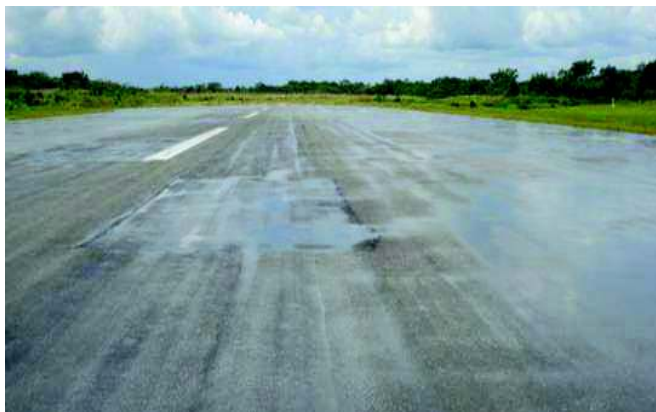
FIGURA 01 - Empocamento de água
